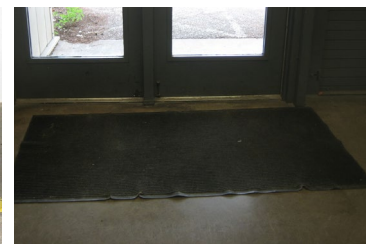
D) Rippling edge creates trip hazard
